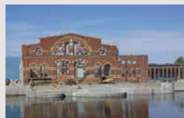
I Varvsstaden i Malmö omvandlas den ikoniska byggnaden Gjuteriet, där man tidigare gjöt fartygsdelar, till en modern och hållbar mötesplats. Projektet färdigställs under 2023 och sker genom det med Balder samägda bolaget Centur.
